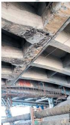
Заглянув под мост, можно увидеть потрескавшиеся балки его самой старой - центральной - части
